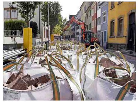
Säckeweise Pflastersteine sind in die Turmstraße geliefert worden, jetzt wird auch der zweite Teil der Verbindung zwischen Rathausplatz und Rotteckring neu gepflastert.
